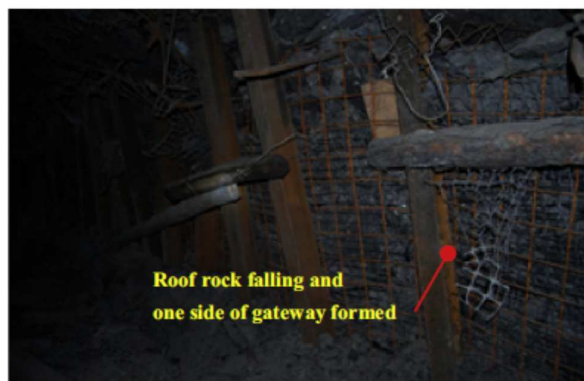
(a) تکیه گاه فولاد و شبکه توری برای ریزش سقف ترکدار
