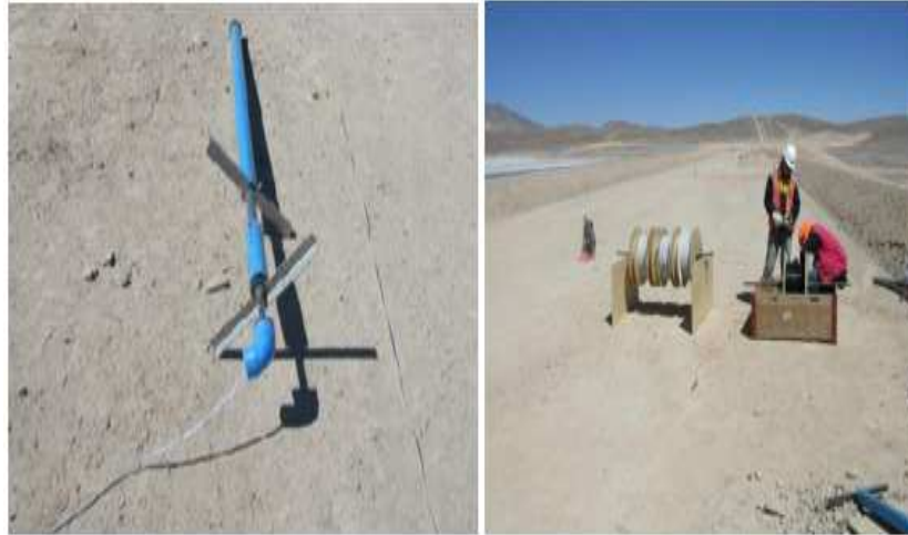
شکل 12: بسته بندی ویژه برای حسگر SOFO و نصب کابل
